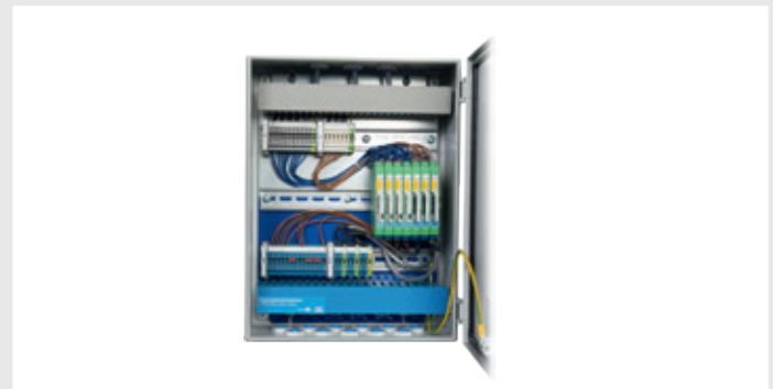
EX-Schutz der Kläranlage mit vollständiger Dokumentation und Prüfung
