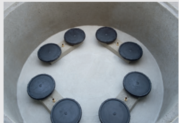
Belüftersystem mit Tellerbelüftern im SBR-Reaktor
