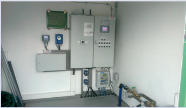
Steuerungstechnik im Betriebsraum
