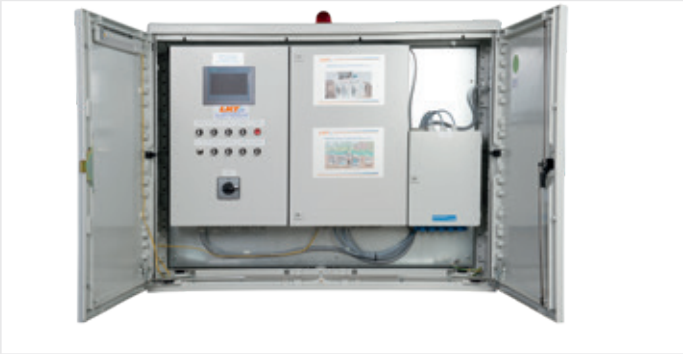
Ansicht des Schaltschranks
