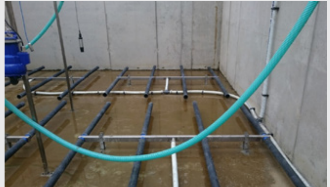
Belüftergitter mit Membranrohrbelüftern im SBR
