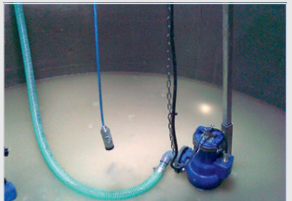
Pumpe am Gleitrohr / Drucksensor zur Niveaumessung
