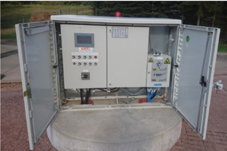
Freiluftsäule mit Schaltschrank montiert auf dem Technischacht
